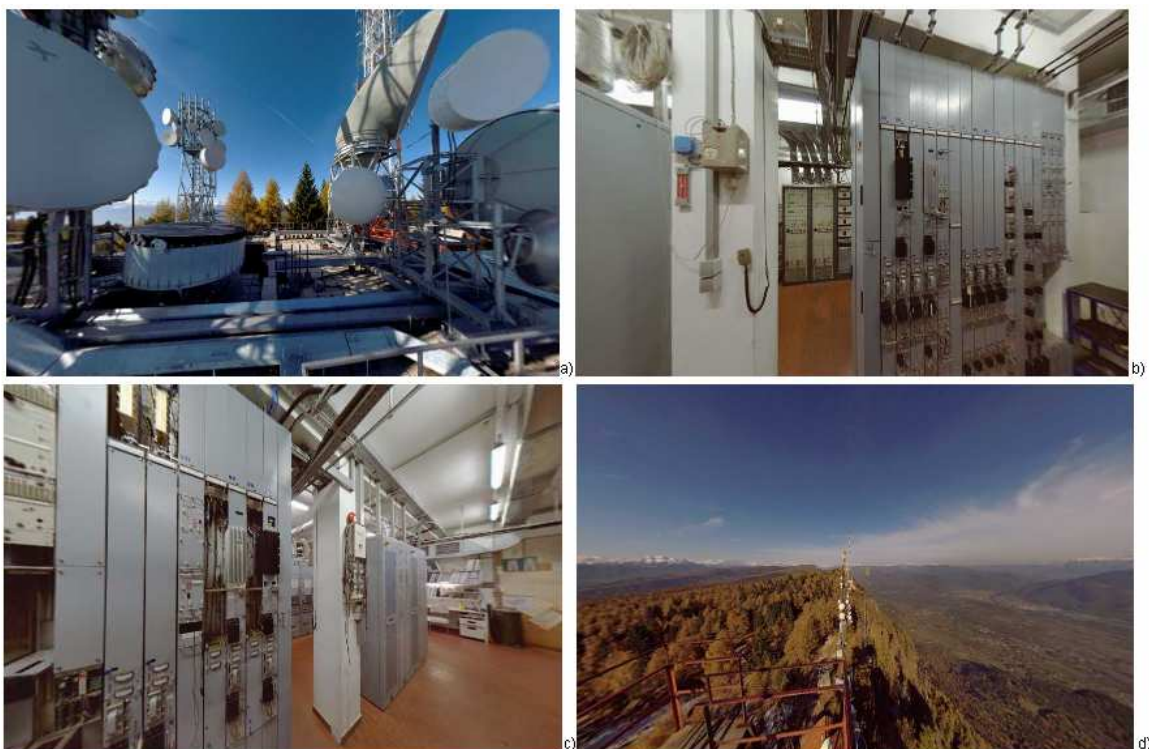
Rys. 10.34. Aparatura nadawcza jednej z cyfrowych stacji radiowych nadających w formacie DAB-T należących do sieci RAS (Rundfunk-Anstalt Südtirol) w Penegal w Południowym Tyrolu w Niemczech.
