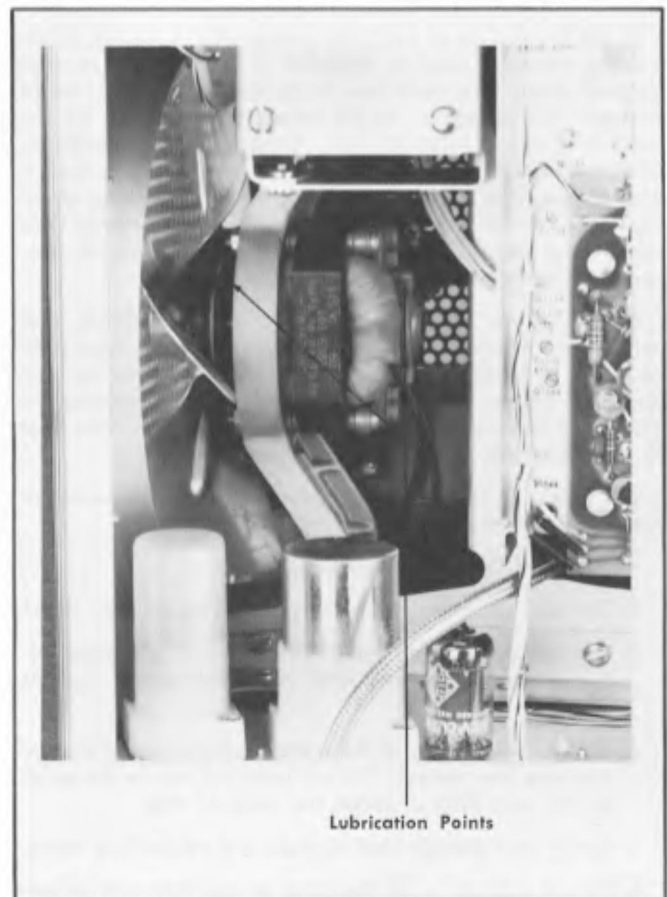
Fig. 4-1. Fan motor lubrication points.
