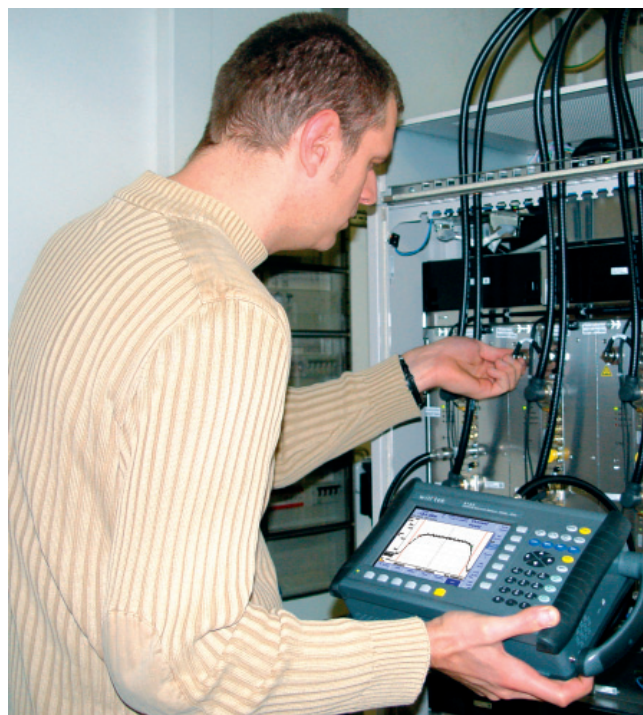
Messung der Kanalleistung an einem UMTS Node B
